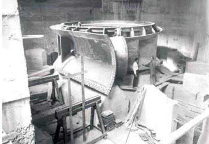
Barrage hydroélectrique de Génissiat. Bâche spirale en phase de montage (août 1946). © A. Berthonnet/Chagnaud
